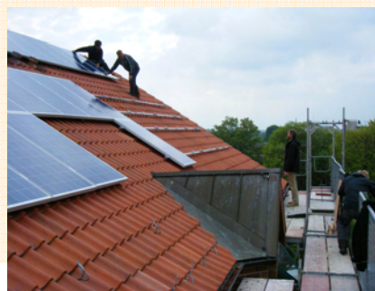
PV- Installation am Rudolf- Harbig- Weg in Münster
